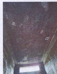
Foto 4: Reparación de losa de sanitarios por deterioro y filtraciones de agua
